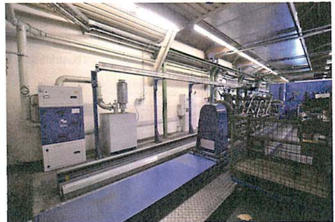
Das Filtersystem „Filtercube“ ist platzsparend außerhalb der Produktion untergebracht.
