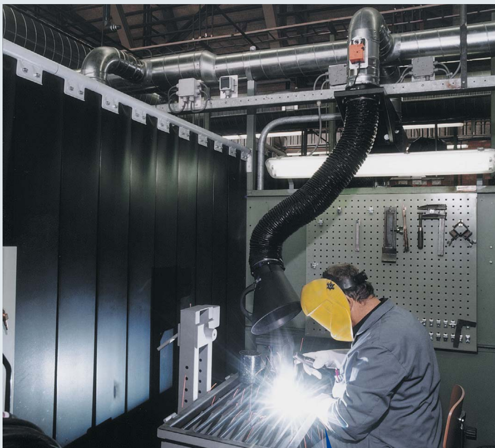
Anwendungsbeispiel: Teleskop-Absaugarm in Schweißkabine
